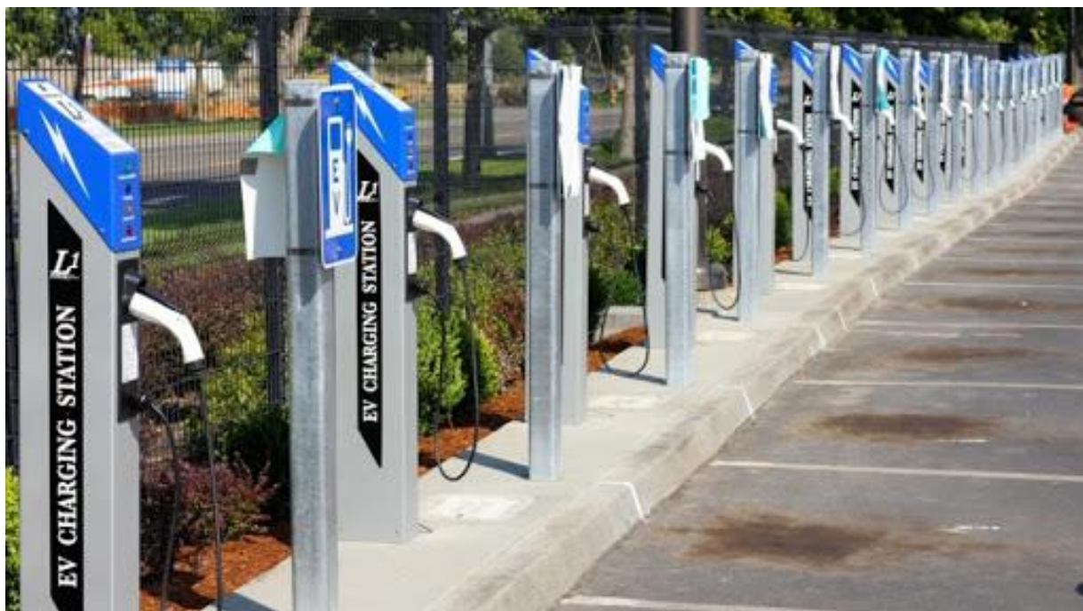
Εικόνα 59: Παράδειγμα σταθμών φόρτισης ηλεκτροκίνητων οχημάτων σε υπαίθριο χώρο.
